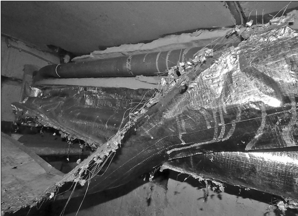
Kaķi, asinot nagus, sabojā cauruļu siltumizolāciju
